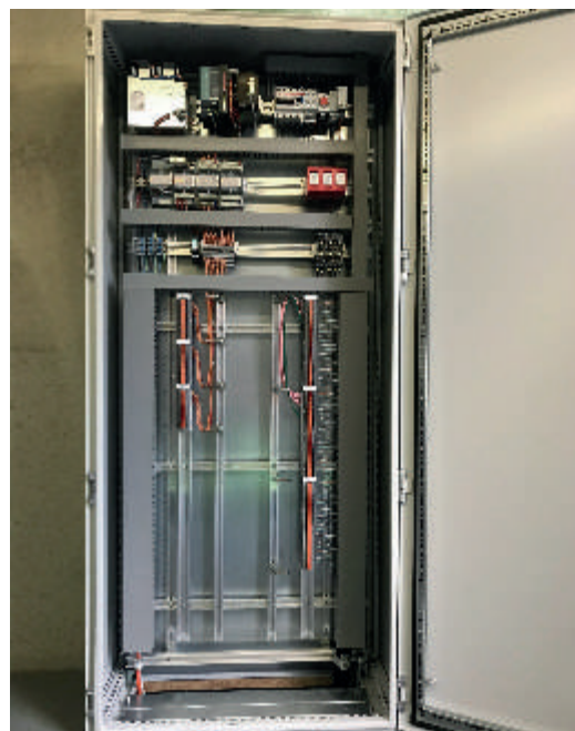
Unterstelle Netzleitsystem TS Gönhardweg
