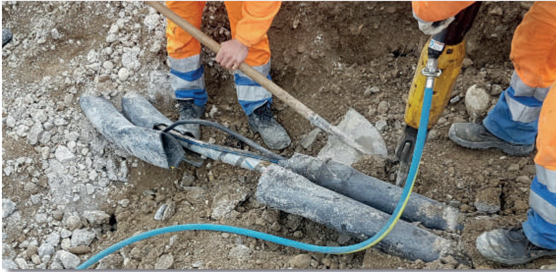
Kabelschaden während Bauarbeiten
