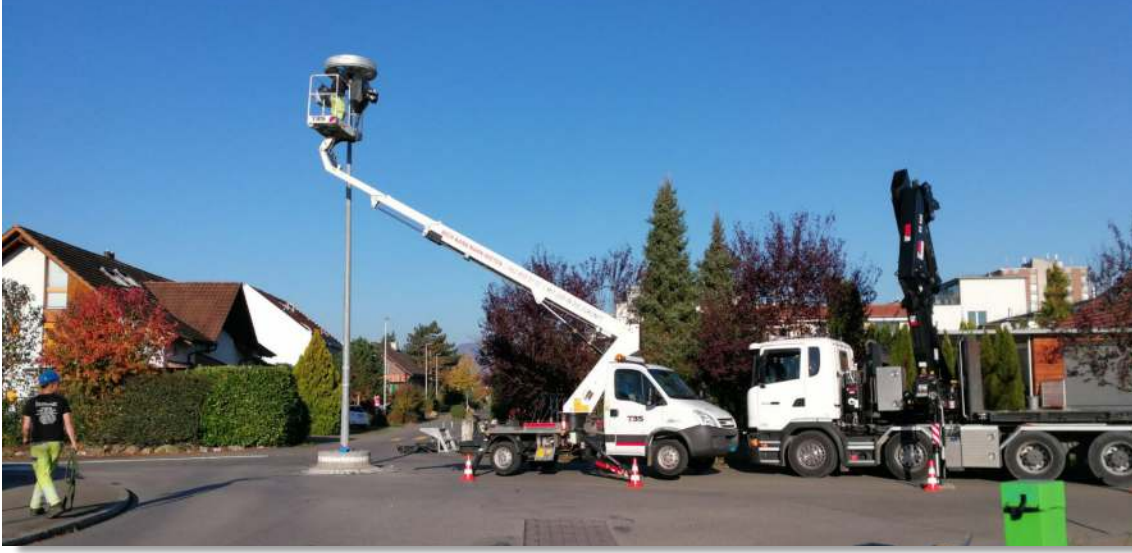
Neue Strassenbeleuchtung mit LED
