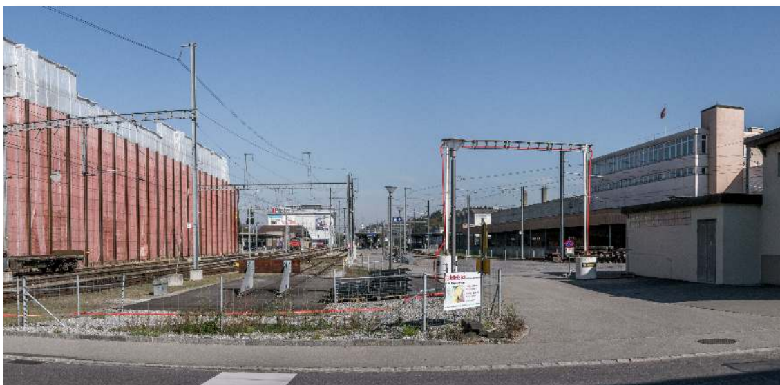
Baustromanschluss ab TS Gränicherstrasse
