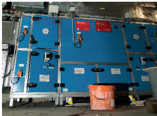
Lüftungsanlage Haus B Henzareal
