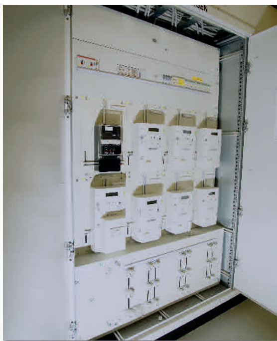
Smartmeter in einem Mehrfamilienhaus
