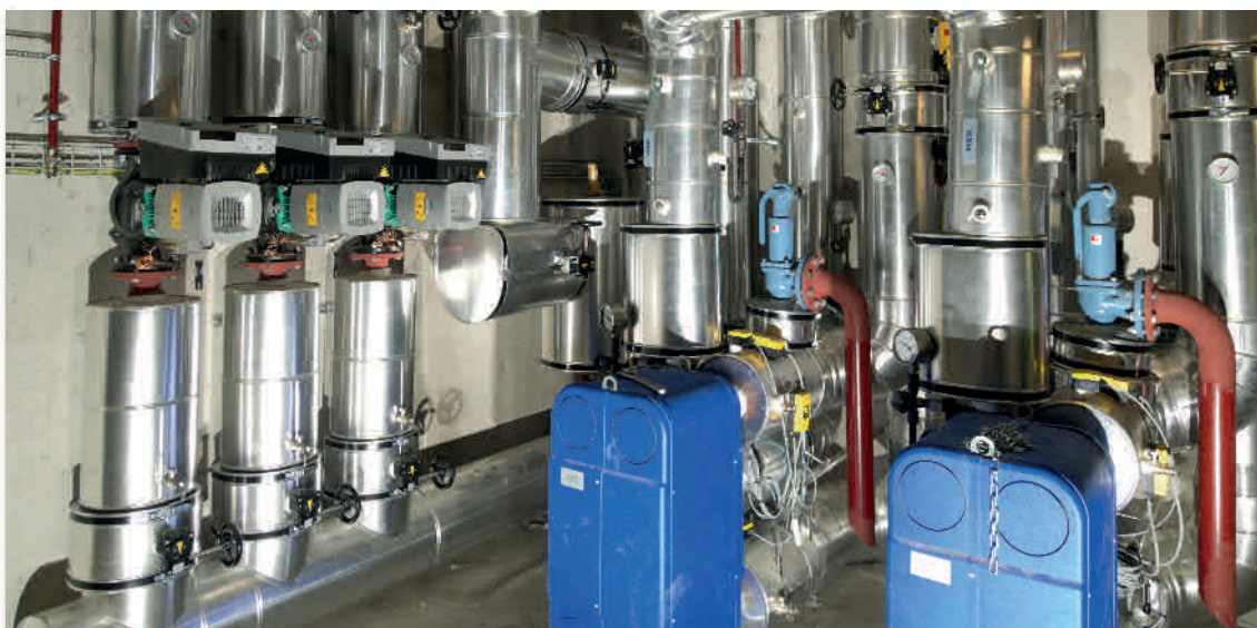
Fernwärmeauskopplung Suhr Süd Henz Areal
