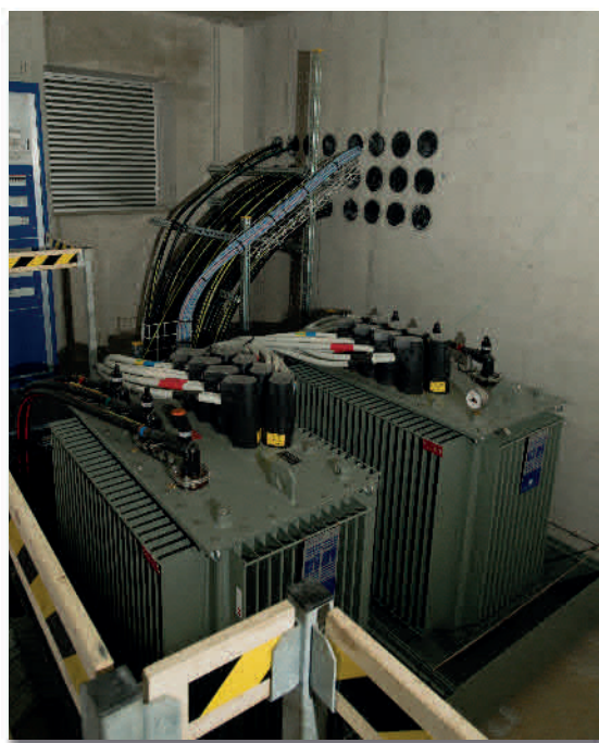
Neue Trafostation Henzareal
