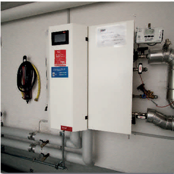
Wärmetauscher im Mehrfamilienhaus Kornweg
