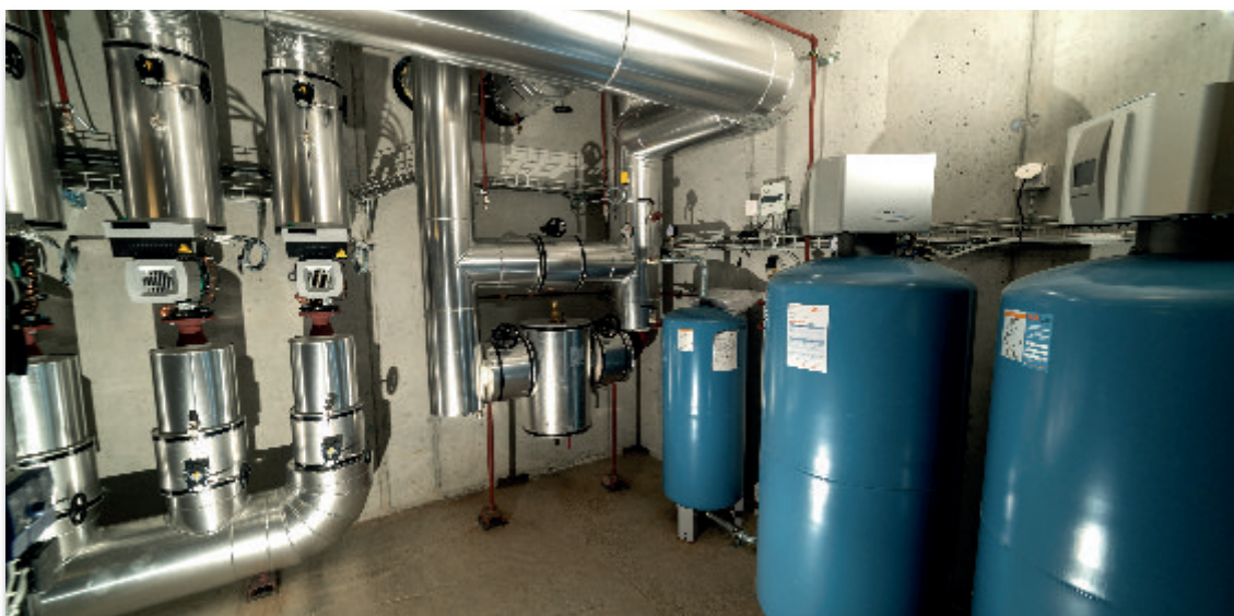
Fernwärme Auskopplungsstation Aarauerfeld
