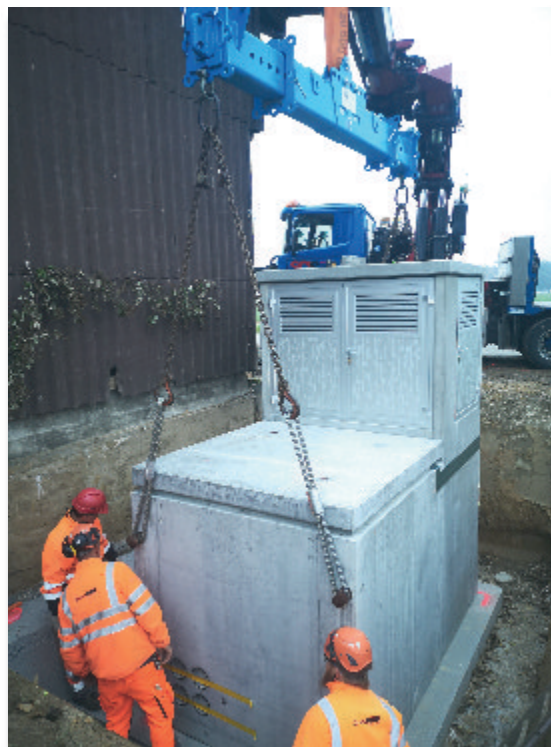
Ersatz Trafostation Holzmatte
