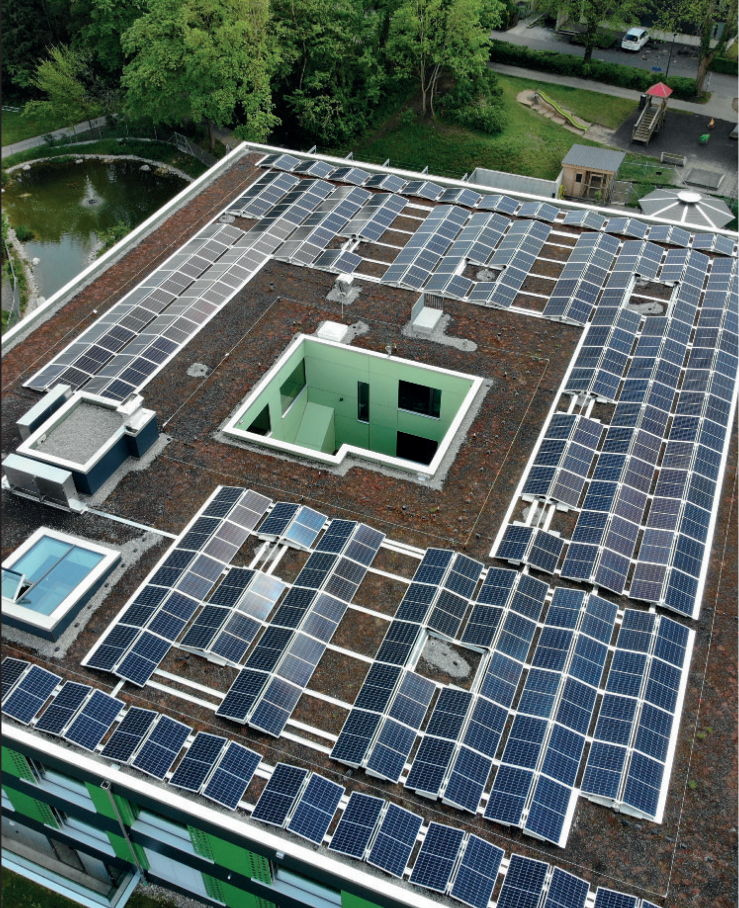
PV-Anlage der IG suhr solar auf dem „Haus am Teich“ mit einer Leistung von 100 kWp
