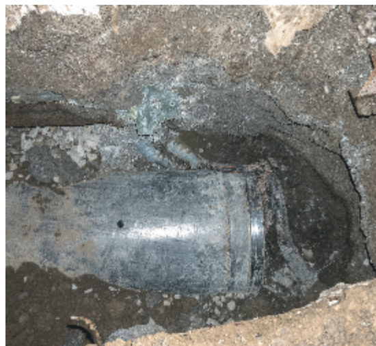
Beim Vortrieb zerstörtes NS-Kabel
